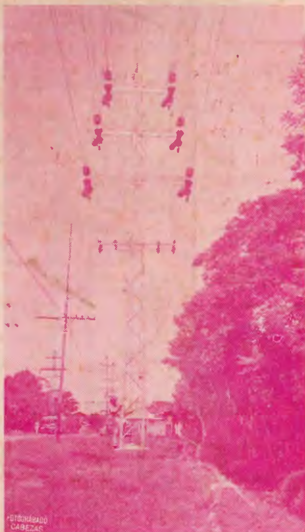
Nuevas líneas de trasmisión de 33.000 voltios
